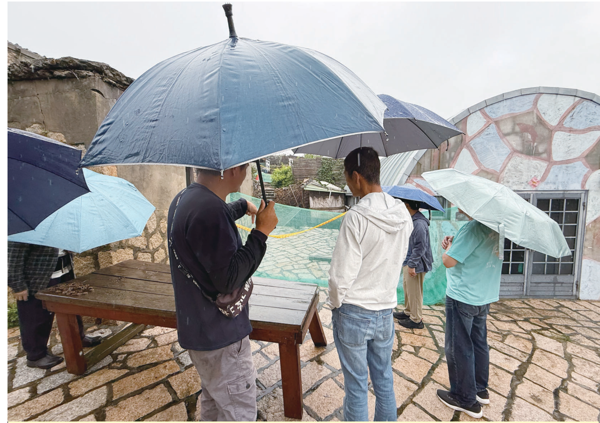
連日豪雨造成東莒大浦聚落魚寮周邊地基掏空，莒光鄉長陳樂禮昨日率員現地勘查；掏空範圍有擴大跡象，提醒鄉親勿貿然前往。(圖/文：蔡夢玲)
