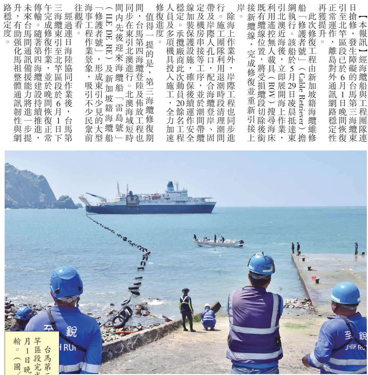
台馬第三海纜東引至北竿區段完成修復，已於6月1日晚間恢復正常傳輸。(圖/文：陳其敏)
