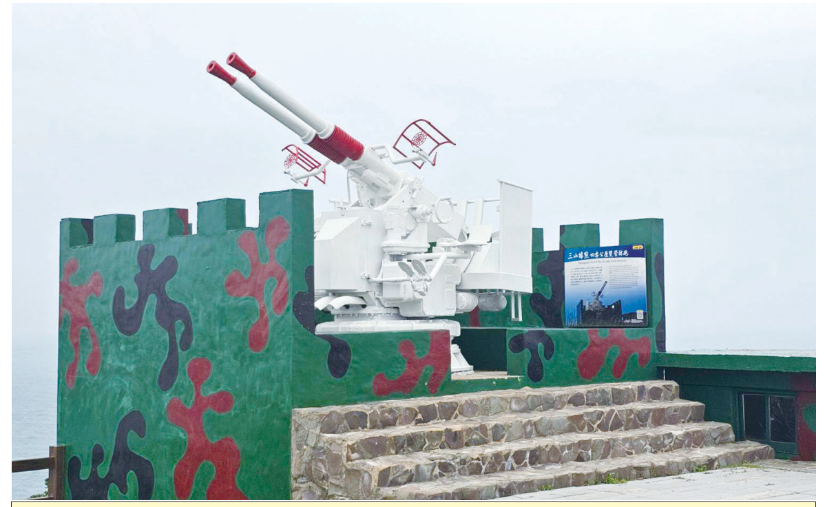
東引三山據點四零雙管防空砲修復完成，將重新提供遊客軍事體驗。(圖：馬祖國家風景區管理處)
