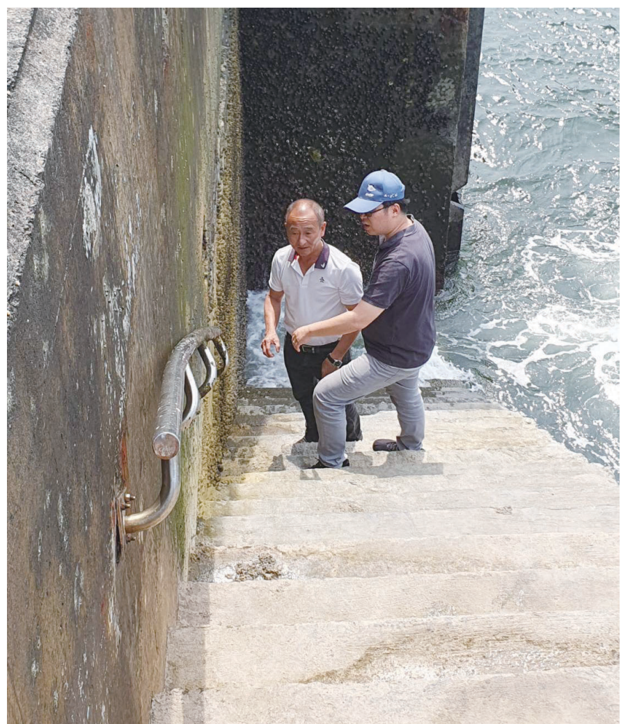
橋仔碼頭護欄部份毀損，產發處邀鄉長吳金平前往現勘改善。(圖：產發處)
