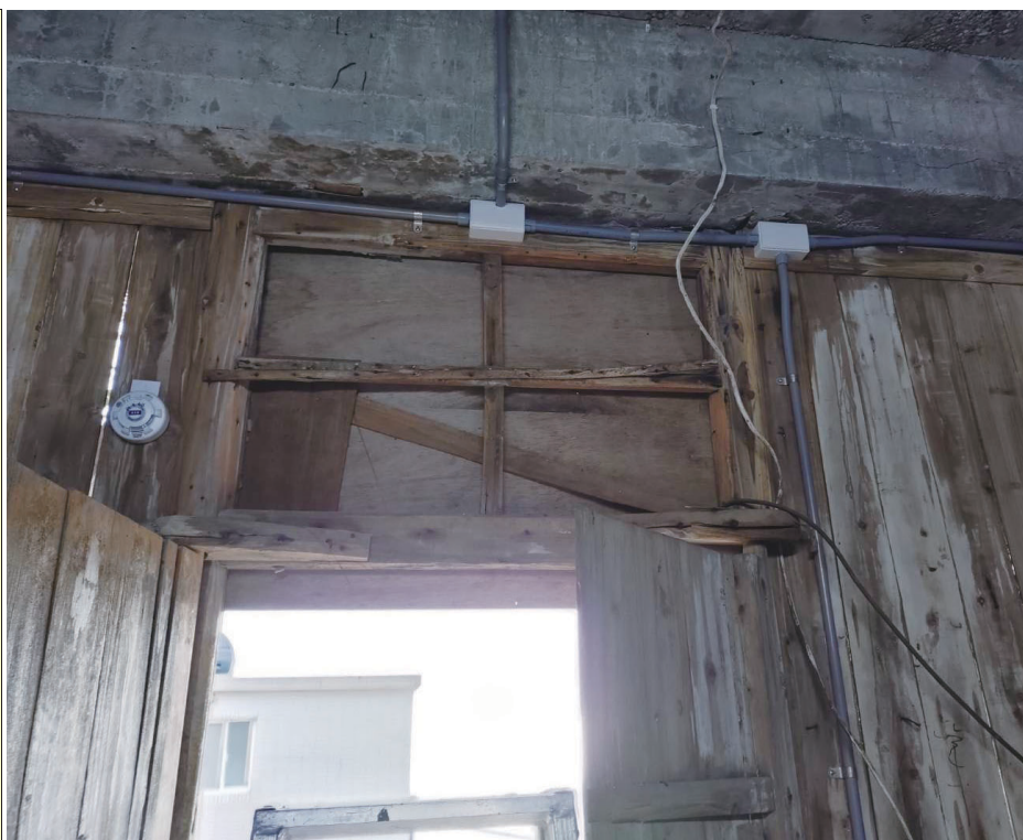
東引環保公司負責人林龍佐熱心公益，協助連江縣推動居家電路設施汰舊換新，守護弱勢長者居住安全。（圖／文：宋幸儒、連江縣消防局）
