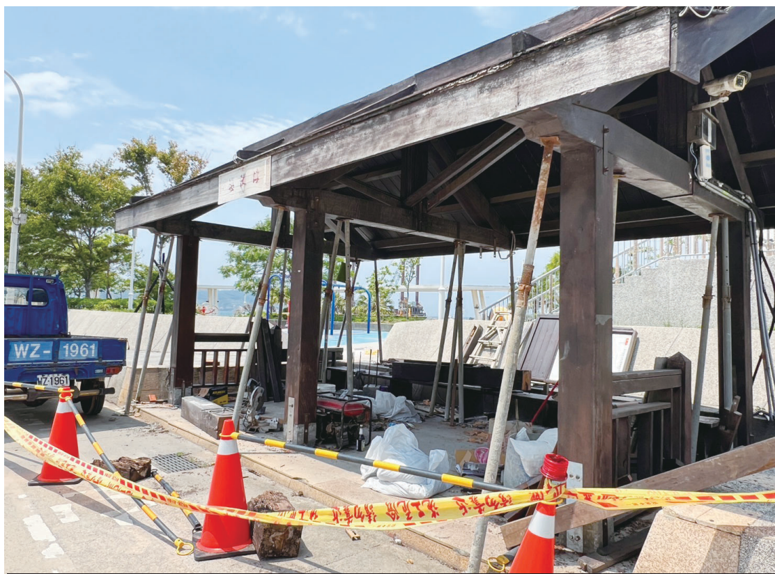
地區部分候車亭年久腐朽，連江縣公車處展開維修工作。(圖／文：馮紹夫)
