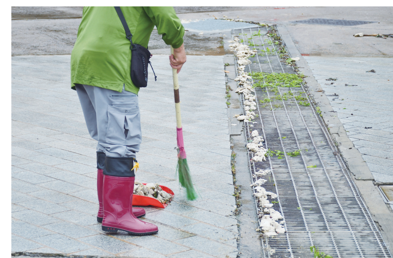
日前大雨，東引忠誠門廣場處的下水道陰井又排出許多白色皂化硬塊，鄉公所尋求縣府工務處、環資局協助改善。（圖／文：陳其敏）
