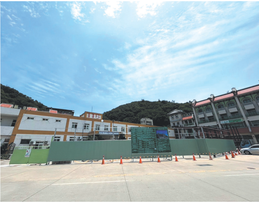
馬祖海巡隊廳舍原址重建，近日廠商將施工區周邊搭建起圍籬，因該處鄰近福澳郵局，提醒洽公民眾要多留意停車問題。(圖/文：曹重偉)
