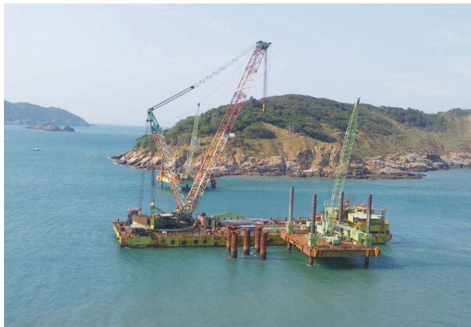
東丕營造董事長王銀和2日拜會縣長王忠銘，他強調海事工程機具已進駐，最困難的橋墩將開始施工。(圖：工務處、馮紹夫)
